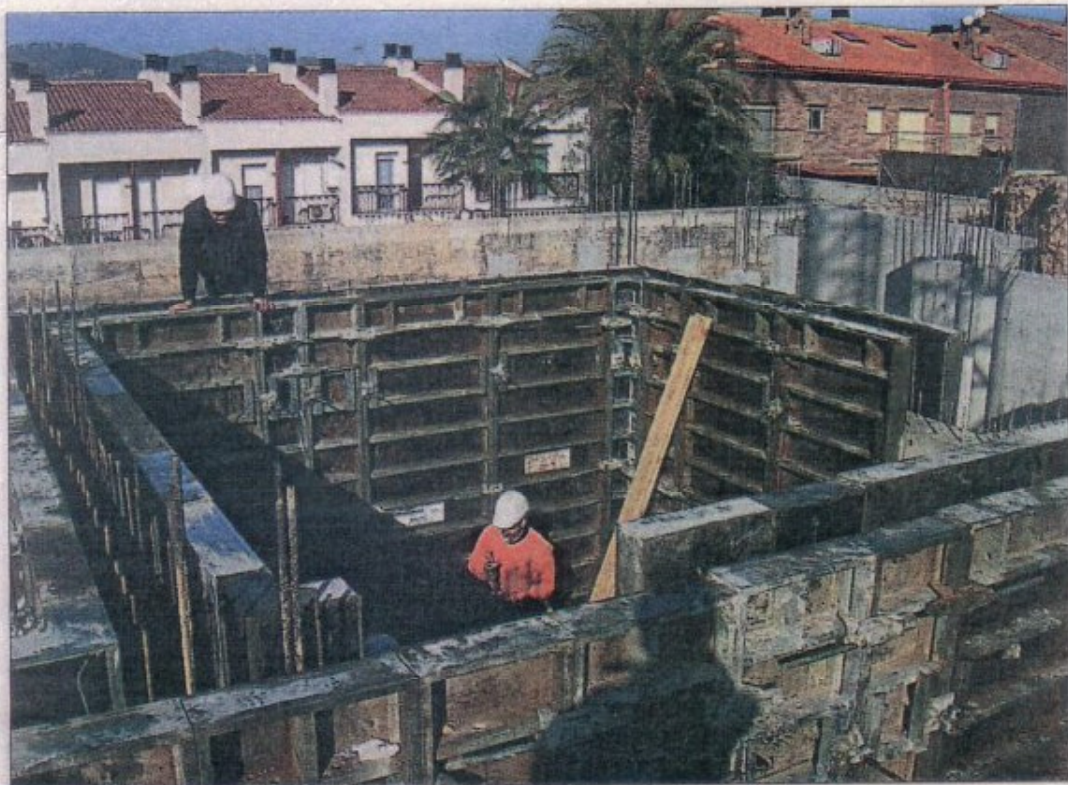
Unos obreros levantan la estructura de hormigón armado de un refugio antiatómico.
